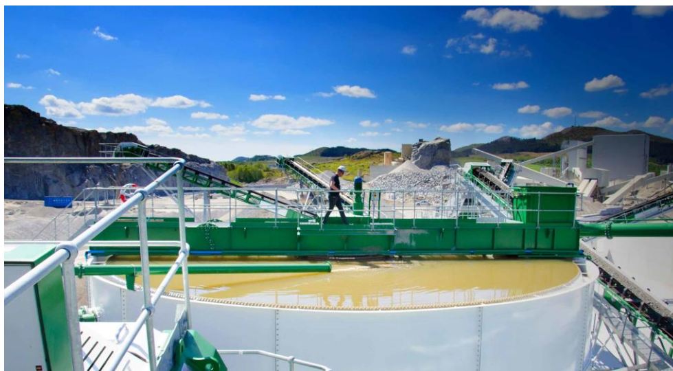
Figur 16: Eksempel på vannrenseanlegg knyttet til vaskeanlegg. Bildet er fra Velde Miljø AS sitt anlegg utenfor Sandnes.
