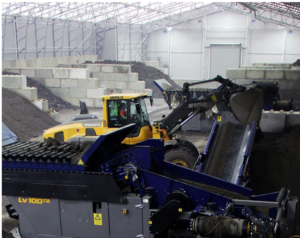
Figur 15: Massegjenvinningsanlegg i Stockholm som er etablert under tak.
