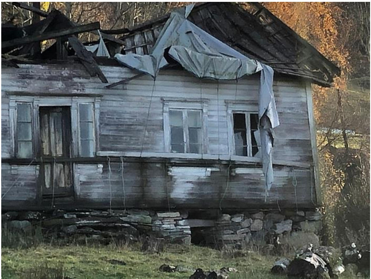
Figur 4.7. Det er når kulturminner går ut av opprinnelig bruk de er i størst fare. Mange bygg i Rogaland forfaller på grunn av manglende bruk og vedlikehold, særlig i utkantstrøk
